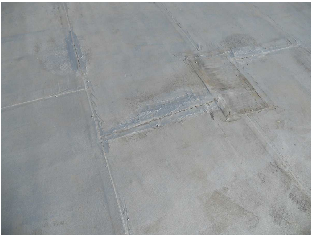
manto impermeabilizzante danneggiato
