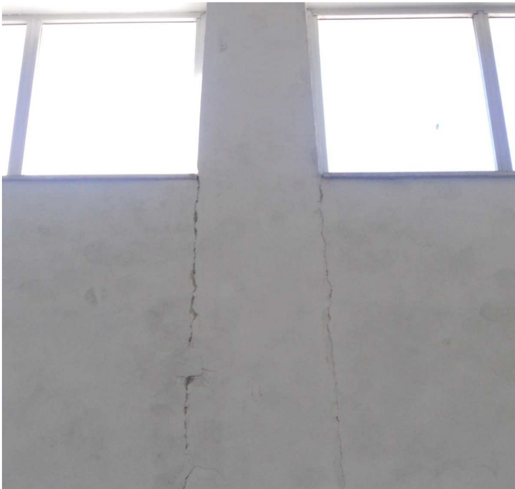
distacco di intonaci tra elementi strutturali
