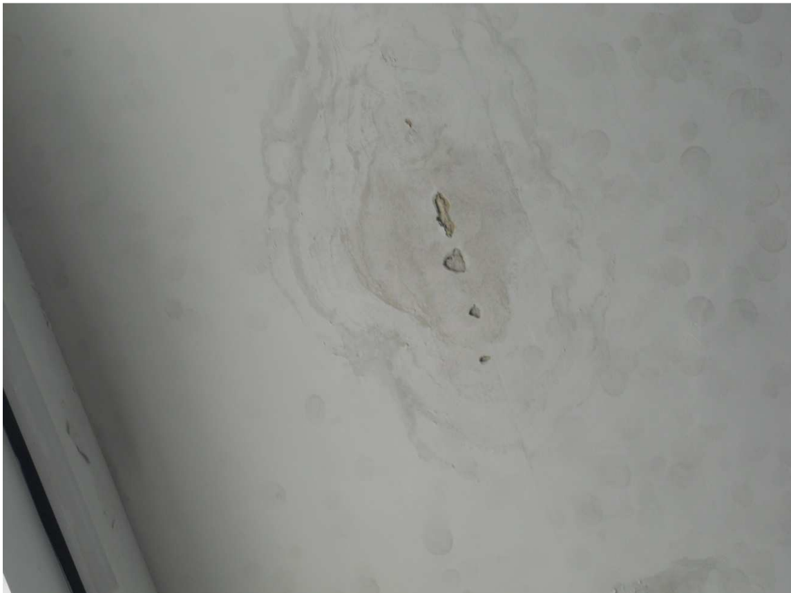
distacco di intonaci
