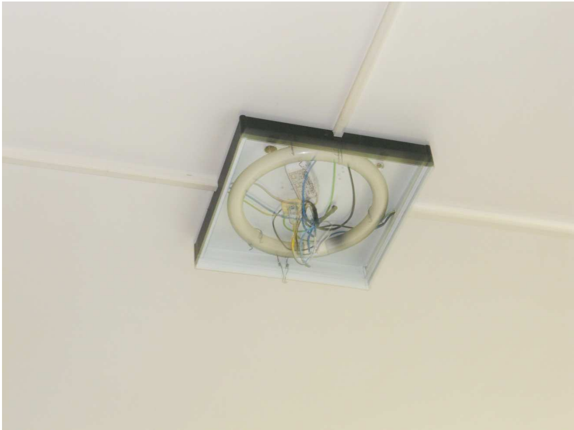
corpi illuminanti non adeguatamente completi e fissati
